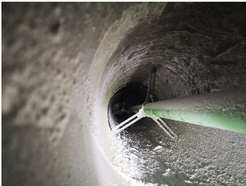
Abbildung 17: In der Bohrung B01-030 mittig positioniertes Rohr
