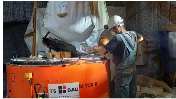
Abbildung 61: Befüllung des Zwangsmischers Filamos m 750 H mit Steinsalz
