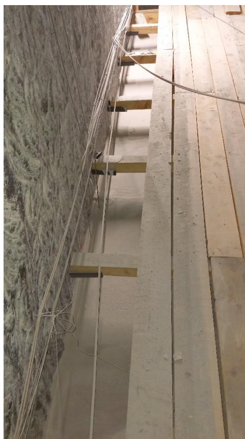
Abbildung 77: Keine weiteren Oberflächenrisse entlang des Dammbauwerkes
