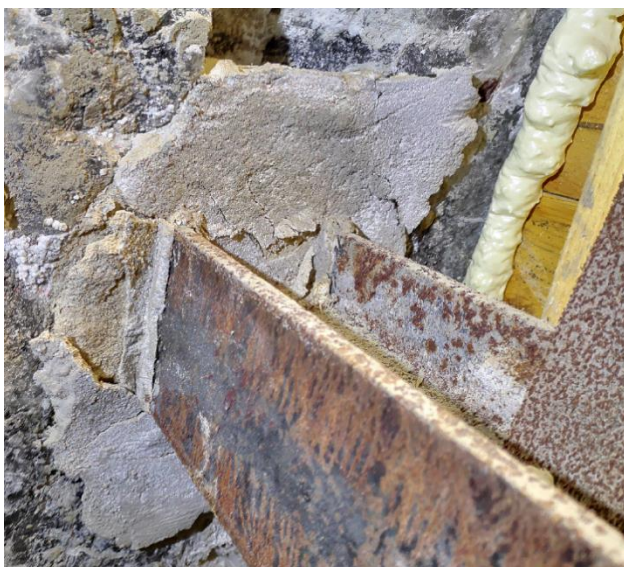
Abbildung 75: Risse im Mörtel an der Verlagerung eines I-Trägers am Stoß
