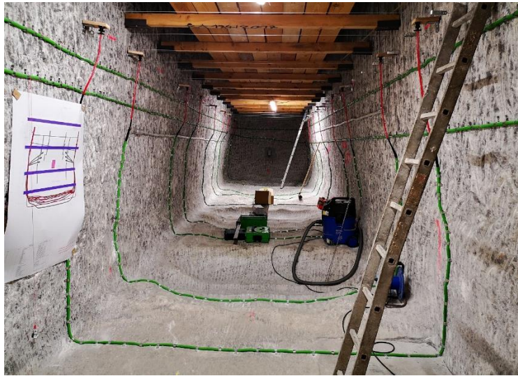
Abbildung 40: Vertikale und horizontale Injektionsleitungen
